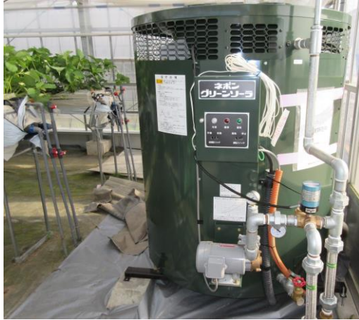
熱供給施設（温水ボイラー）
