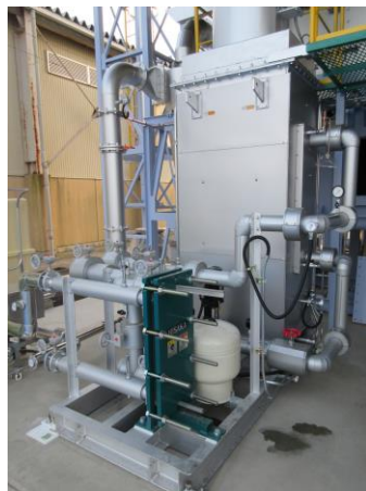
ボイラー（熱交換機）
