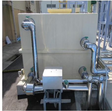
熱供給施設（貯湯槽）
